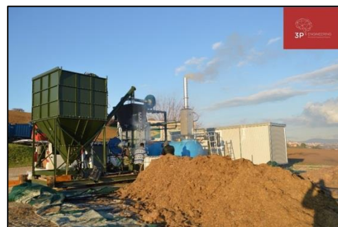
Figura 3 – Impianto CHIMERA installato in un allevamento di polli da carne (foto: progetto LIFE CHIMERA)
