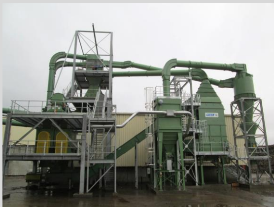
Foto 2 – Impianto CARWASTE a Rocquancourt in Francia (foto: GDE)
